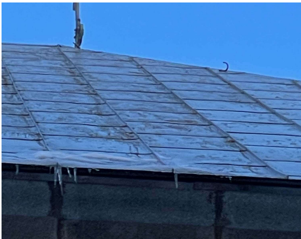
Fot. 2 Widoczna degradacja i korozja powierzchniowa pokrycia dachu głównego
