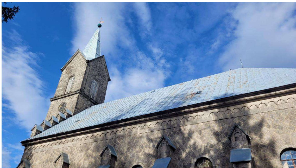
Fot. 3 Widoczna degradacja i korozja powierzchniowa pokrycia dachu głównego oraz brak rynien i rur spustowych.
